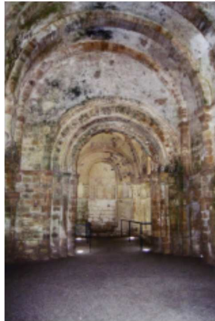
Schwärzung an Außenwänden
